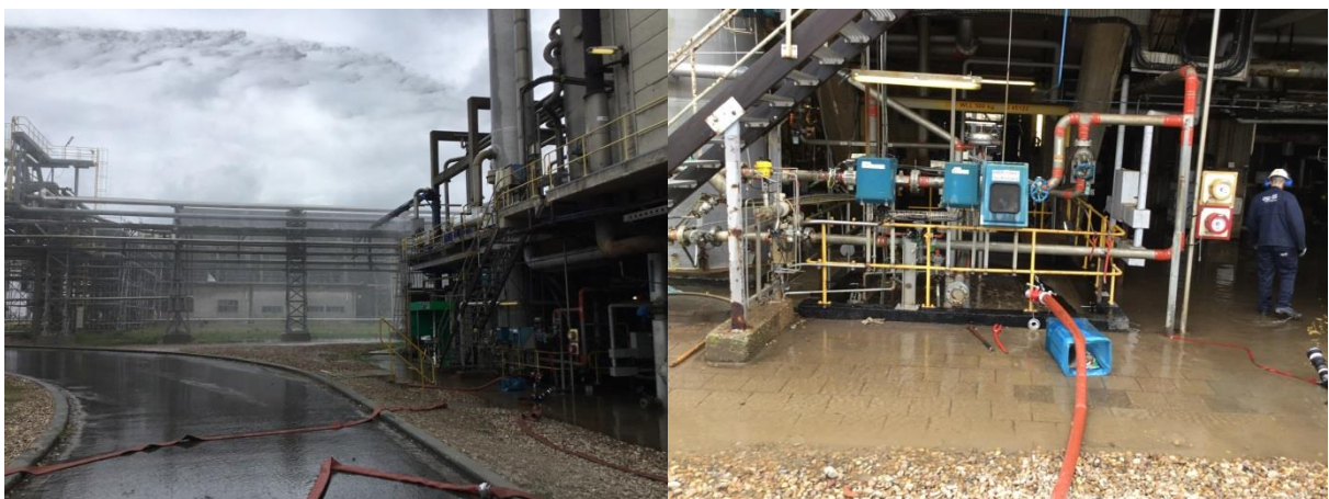
Figuur 1 foto's van betreffende installatie
