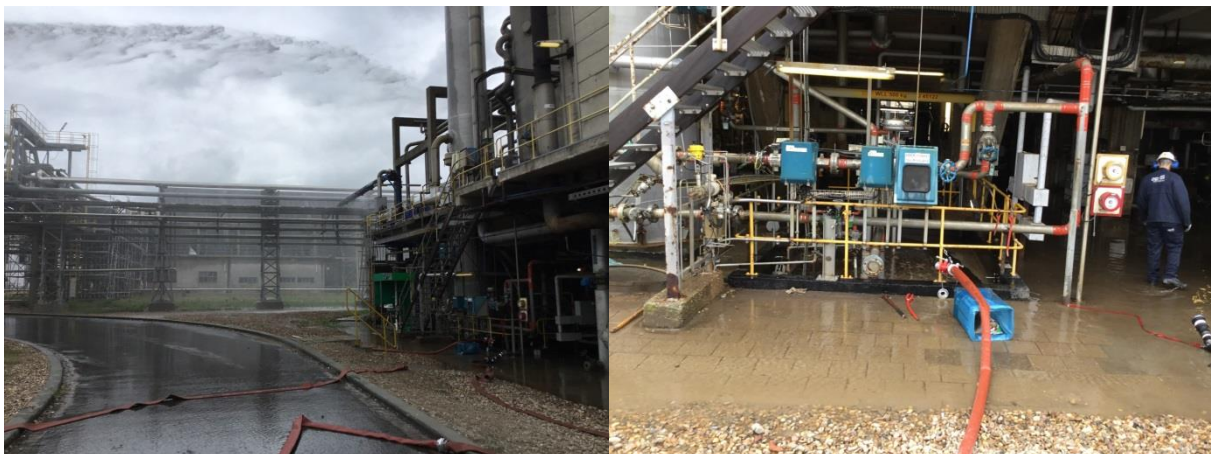
Figuur 1 foto's van betreffende installatie
