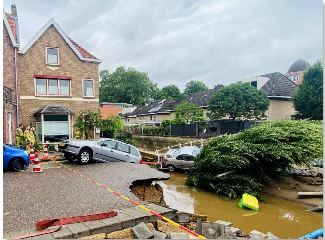
Afbeelding 2 Sinkhole en schade
